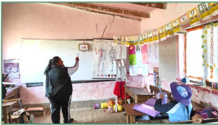
Schäden im Mauerwerk
